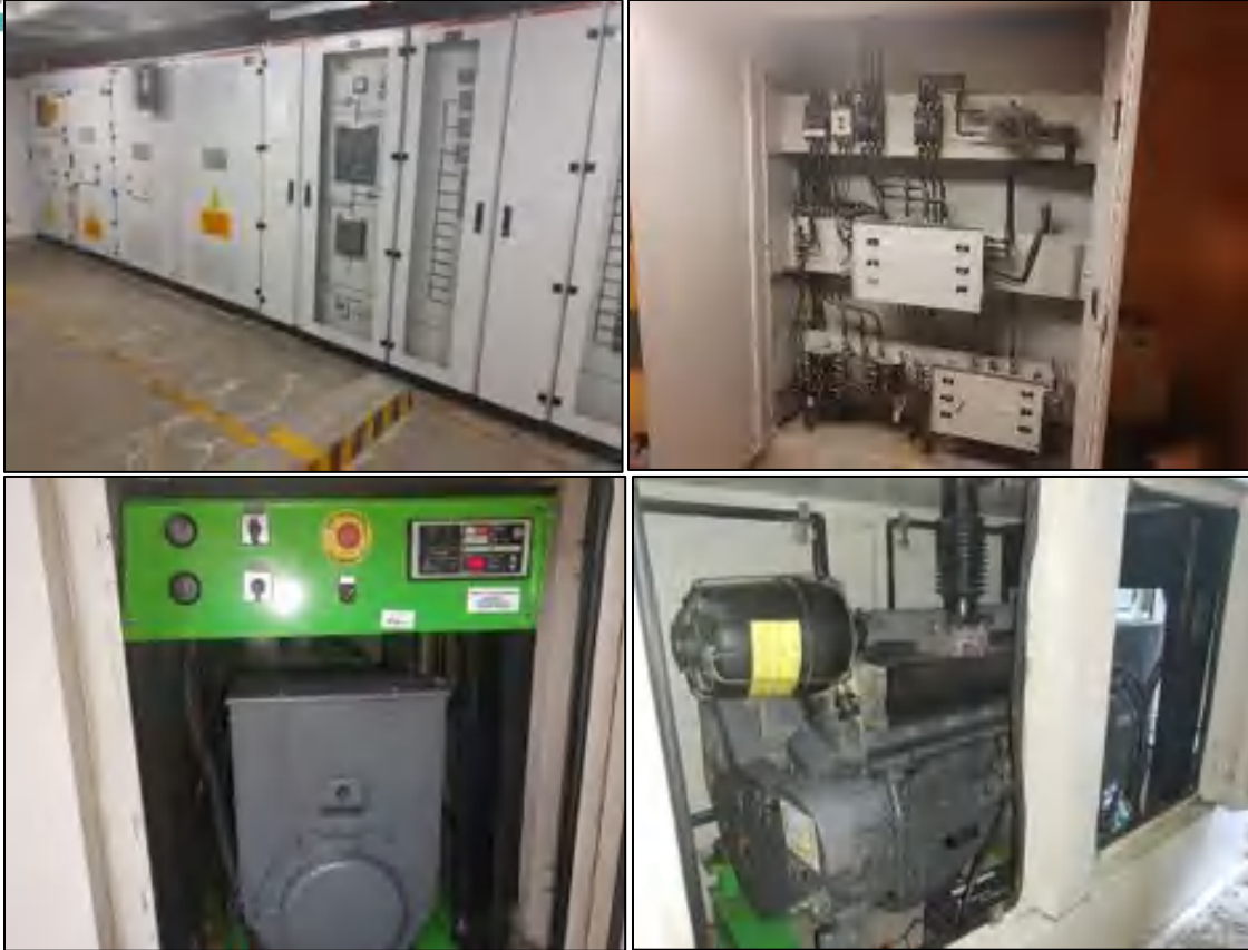
Imagen 66, 67, 68 y 69. Subestación eléctrica.
